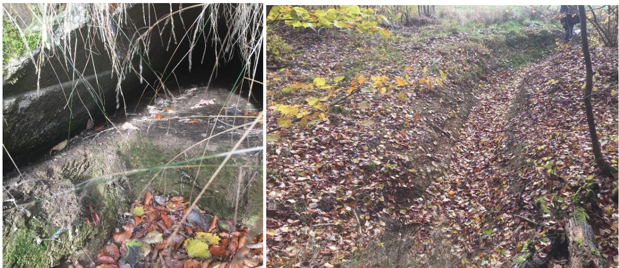
Abbildung 17: Zugesetzter Durchlass durch den Bahndamm und Auslauf der Verrohrung
